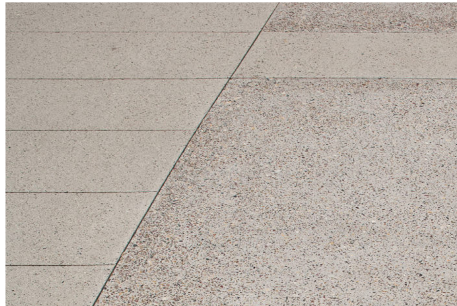
Harbour Drive Bridge, San Diego Beton Toplaag deels uitgewassen
